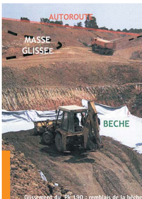
Glissement du Pk 190 : remblais de la bêche
